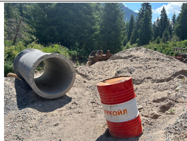
Фото 18: Строительные материалы, подлежащие уборке
