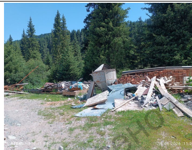
Фото 16: Строительные материалы, подлежащие уборке
