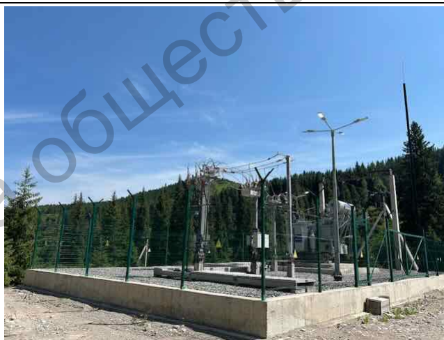
Фото 17: Распределительное устройство рядом со зданием ГЭС
