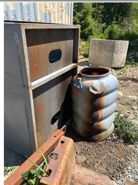
Фото 12: Строительные материалы у здания ГЭС, подлежащие уборке
